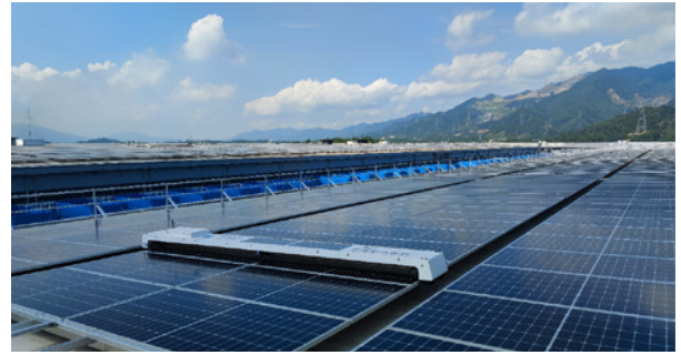
腾讯数据中心屋顶光伏
