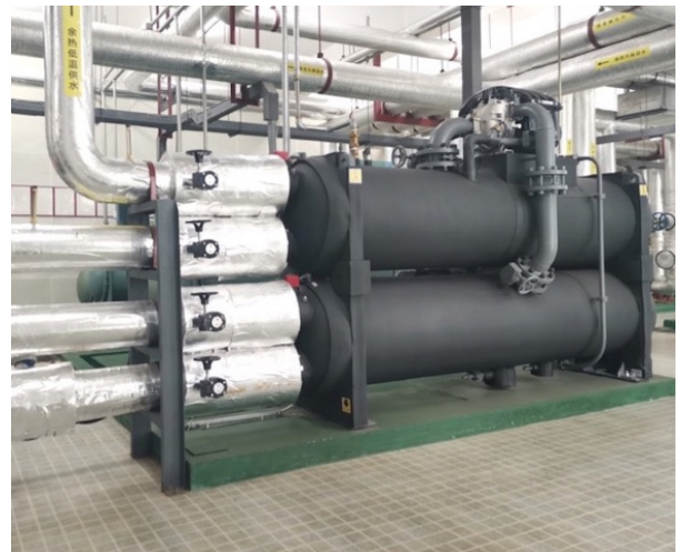
天津数据中心的余热回收系统
